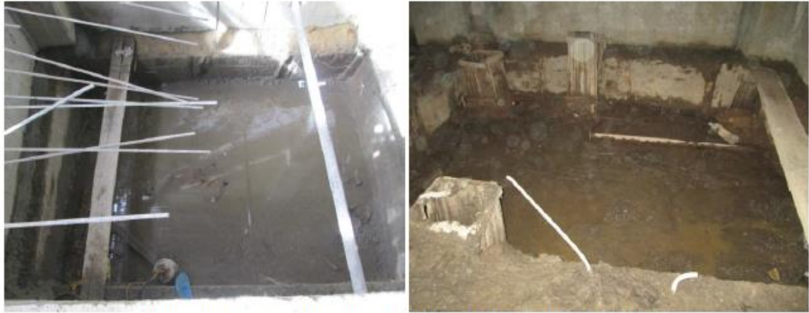
Foto 1 y 2. Empozamiento de aguas - 03 de octubre de 2013.
