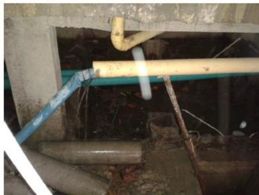
Foto 3. Evacuación de aguas provenientes del sótano - 12 de noviembre de 2013.
